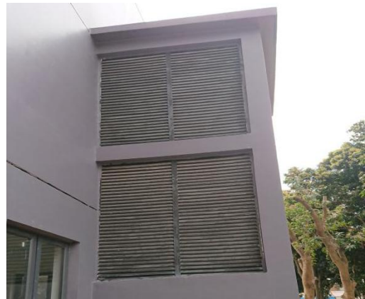
备用发电机废气排气井
