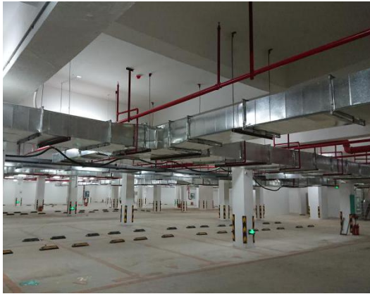
地下室通风排气系统
