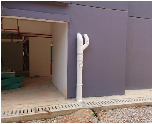
项目生活污水排污管道
